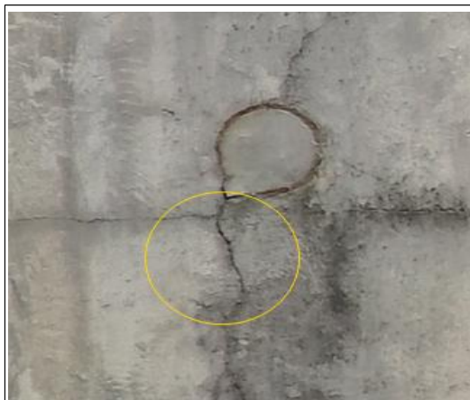
a. Pier4. 우측면 균열의 검출
